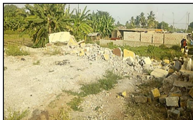
Photo 1b : Chantier détruit à Tolakouadiokro
