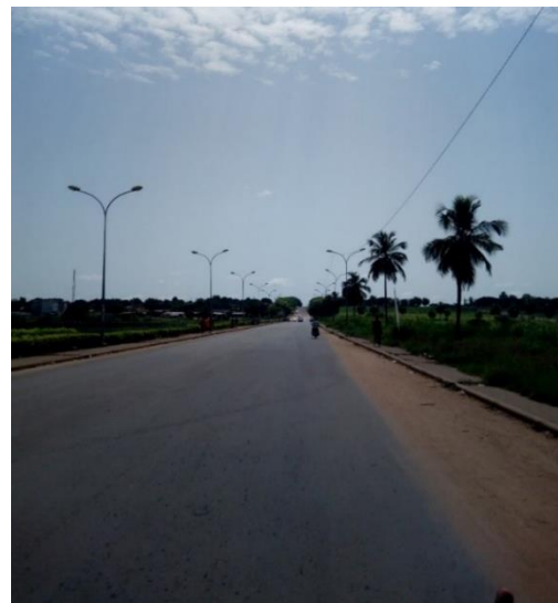
Photo 2 : État de la voirie au quartier N'zuessy en 2023
