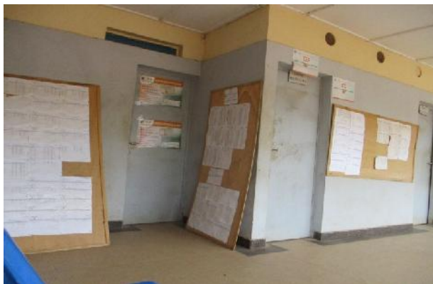
Photo 1 : Dégradation des murs de la sous-préfecture de Mankono par des notes d'information Prise de vue : Koné Kapiéfolo J., 2017
