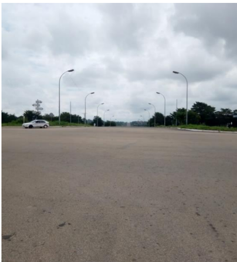
Photo 1 : État de la voirie au quartier Assabou en 2023
